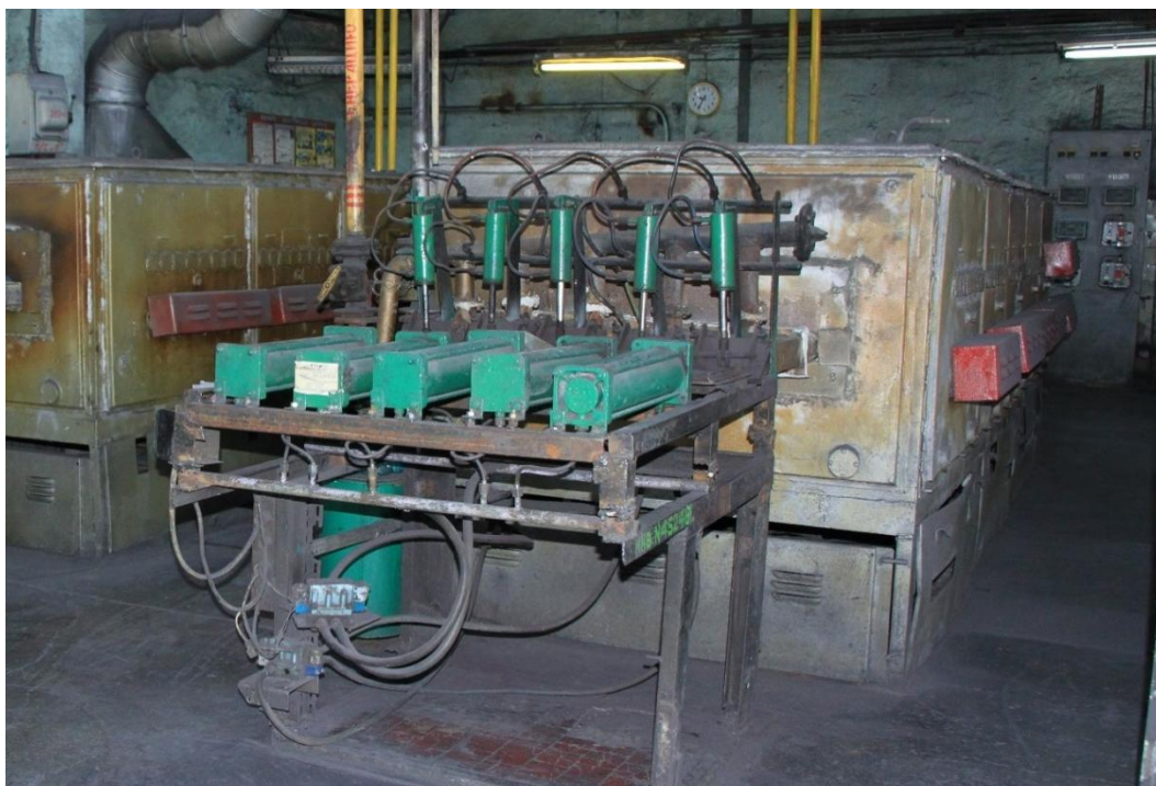
Рисунок 3 - Электродпечь сопротивления толкательная типа СТН – 1,6
